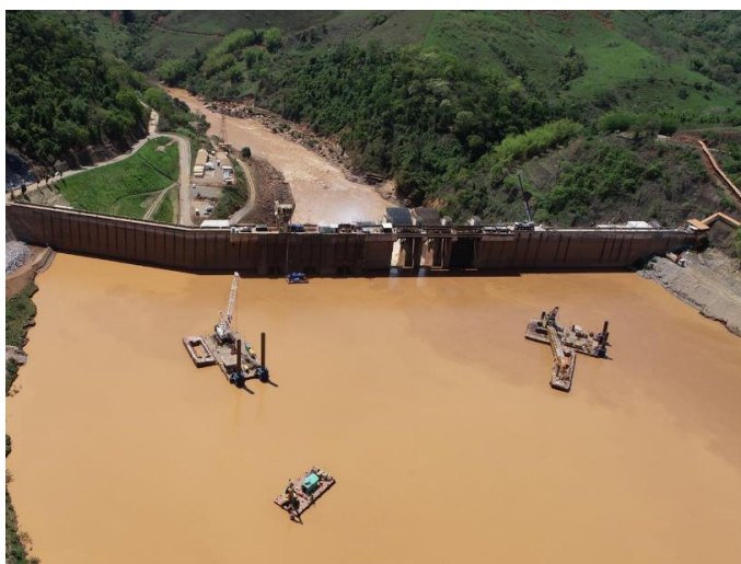
Figura 2 – Remoção de sedimentos de dois conjuntos guindaste/ balsa e um conjunto escavadeira/balsa
